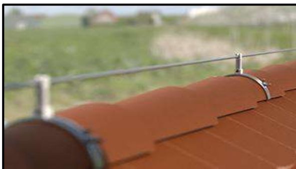
Система молниезащиты и заземления
