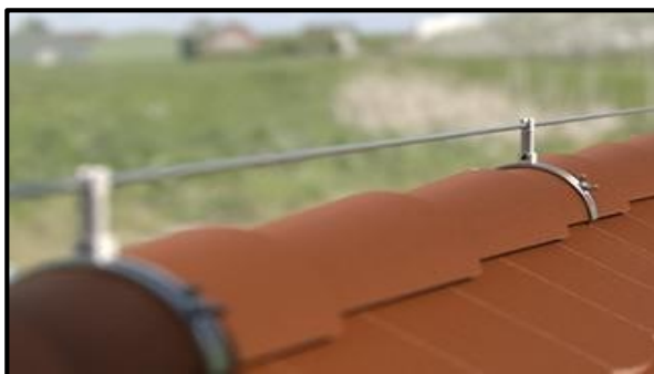
Система молниезащиты и заземления
